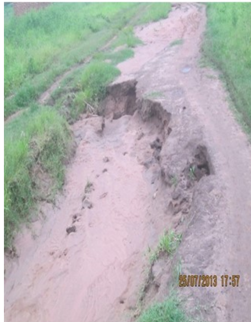
Photo N°1. Dégradation de la route secondaire Laoukassi-Beissau par érosion
